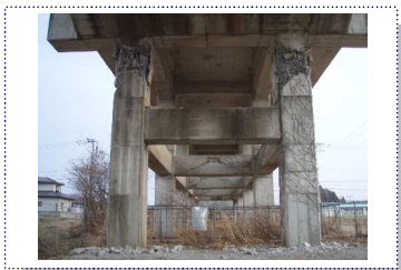
本震(3,11)による被害状況(2層の破損)
